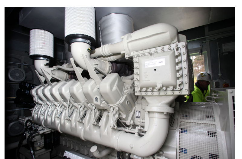
Notstromversorgung eines Wasserversorgungsunternehmens (Foto: Rheinenergie AG Köln)
